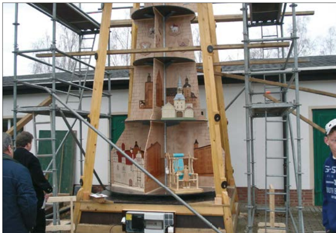
Projekt Glauchau-Pyramide: der Bau der Pyramide im Jahr 2006. Ein Jahr später wurde sie fertiggestellt und eingeweiht. Foto: Verein
