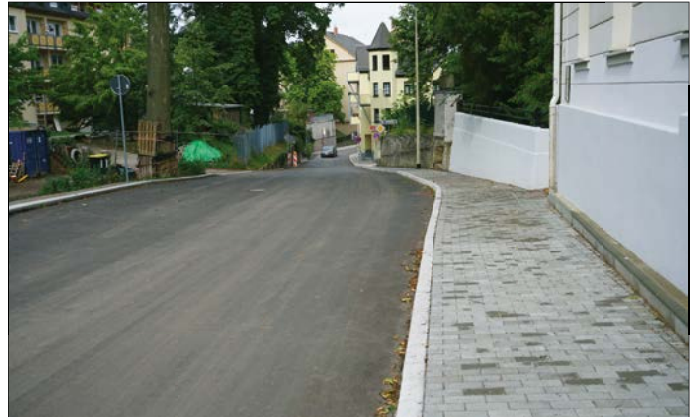
Der einseitig verlaufende Gehweg wird auf der gesamten Baulänge von Schulplatz/Hoffnung bis Rudolf-Breitscheid-Straße grundhaft erneuert. Fotos: Stadt Glauchau
