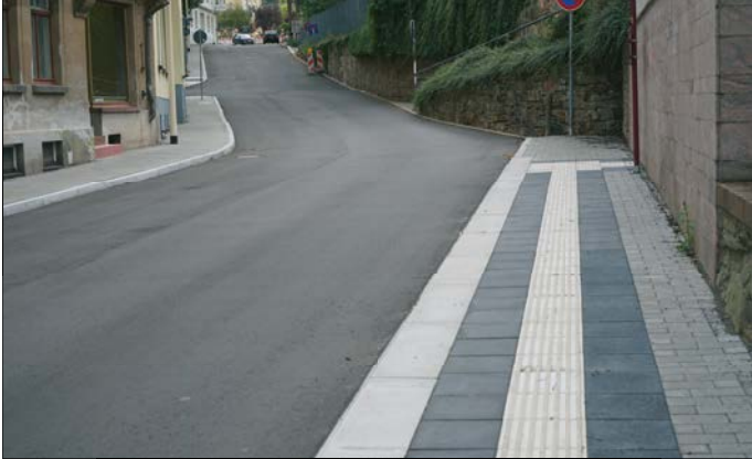
Sichtbar fertiggestellt ist inzwischen der 1. Bauabschnitt. Hier erfolgte der grundhafte Straßenbau vom Schulplatz bis zum Knotenpunkt Agricolastraße/Dr.-Walter-Hüttel-Straße.
